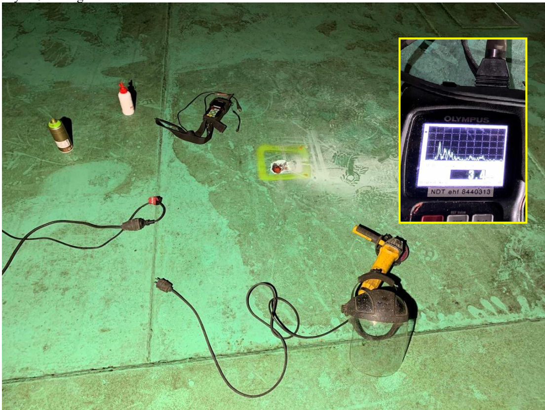
Mynd 6. Tvöfalda þurfti á einum stað í plötu 15. Þykkt fór úr 5,9mm í 3,4mm. Sjá innfelda mynd.
