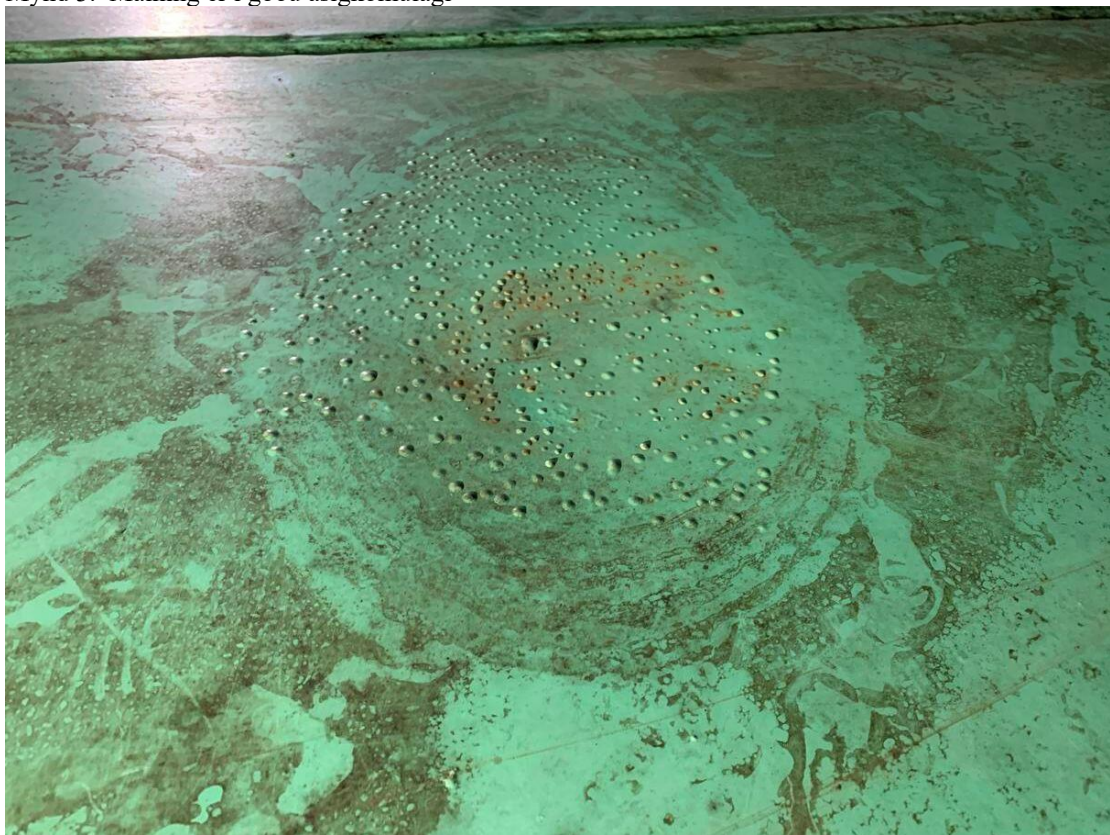
Mynd 4. Einkennileg loftbólumyndun í málningu. Engin tæring fannst við skönnun.
